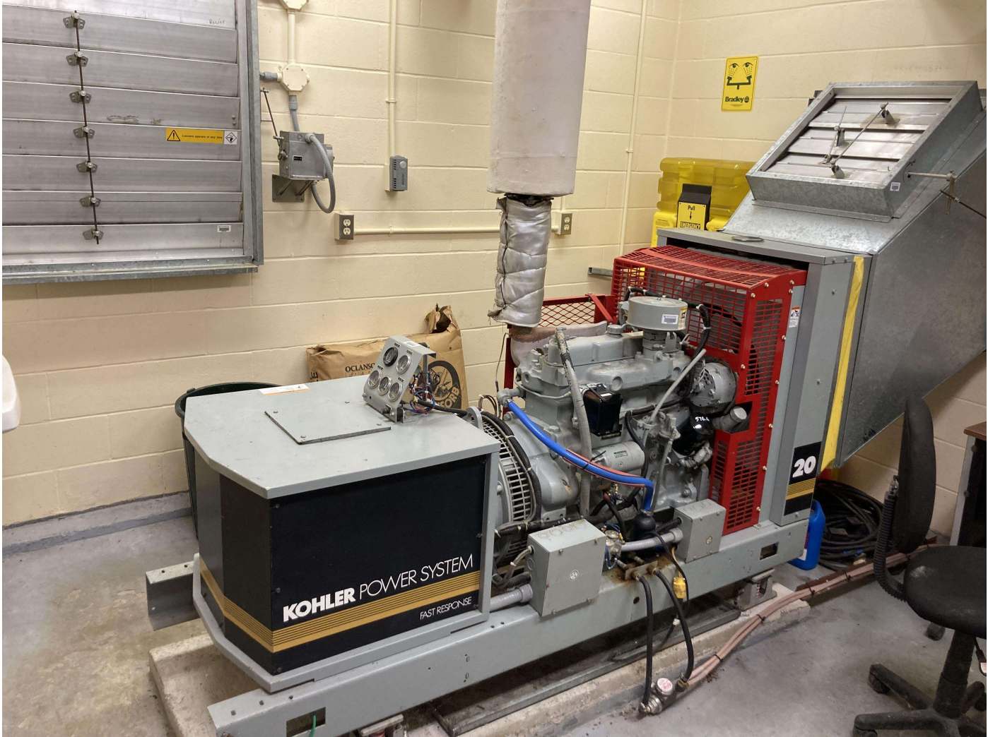
King St. Electrical.jpg
