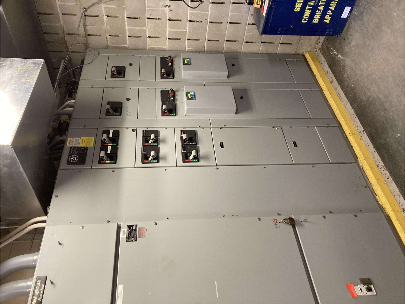
H-111 Vfd Blower #2.jpg
